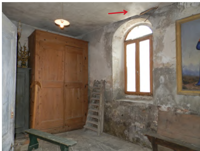
Dégradation des maçonneries et instabilité du plafond infecté par la mérule
