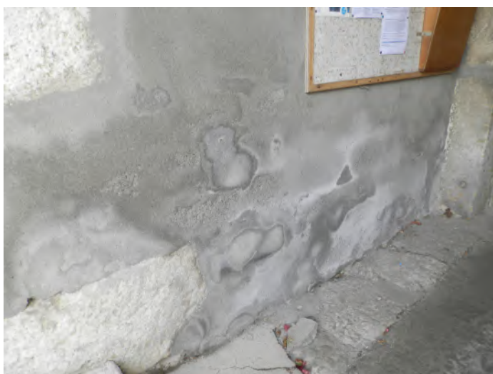
Porche d'entrée - humidité - Remontées capillaires et développement des sels.
