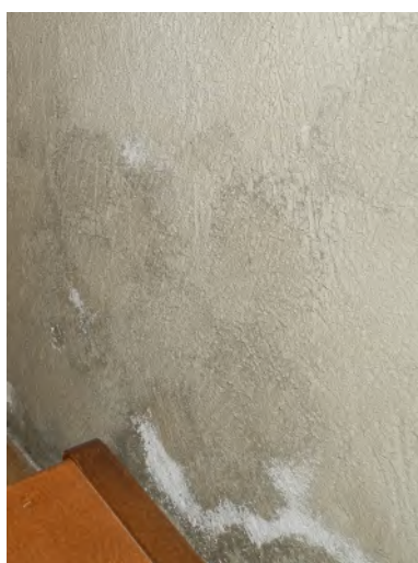
Remontées capillaires Présence importante de sels
