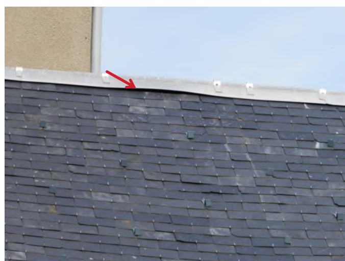
Dilatation de la faîtière en zinc : étanchéité non assurée Mise en œuvre maladroite et disgracieuse des éléments en zinc
