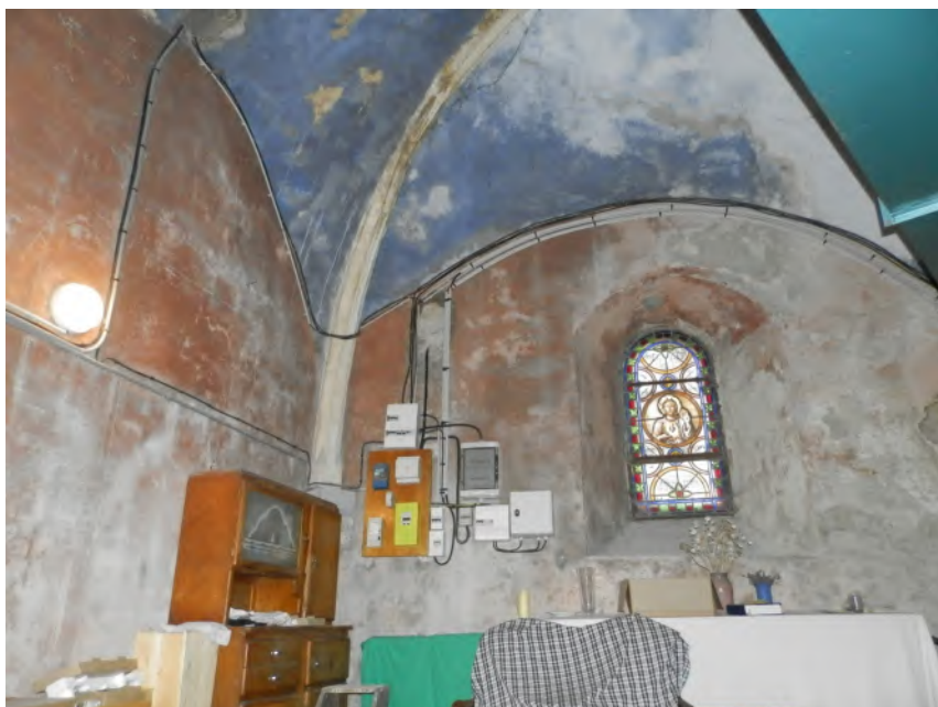
Forte humidité et altération avancée des enduits et décors peints - Chapelle Nord Remontées capillaires - présence importante de sels
