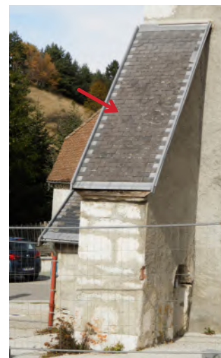
Dégradation de l'ardoise sur tête de contrefort
