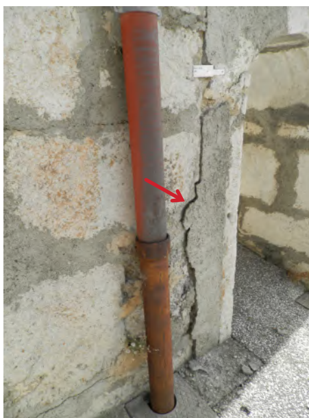
Désolidarisation du contrefort Sud
