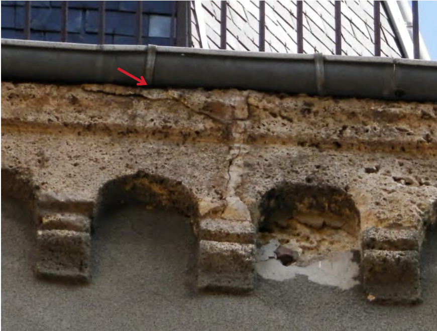
Altération de la corniche de modillons en Tuf - fissuration et desquamation de la pierre
