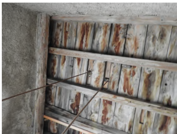
Humidité importante dans les planchers
