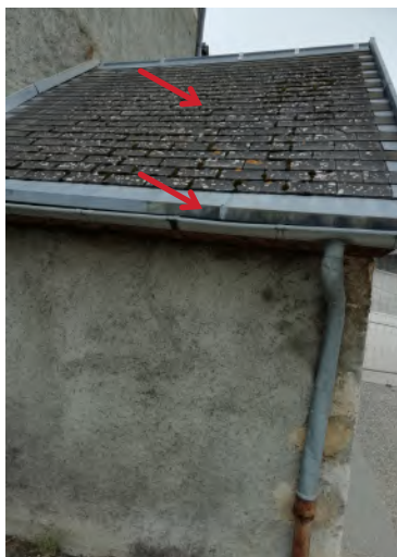
Mousse et dégradation de la zinguerie Porche d'entrée
