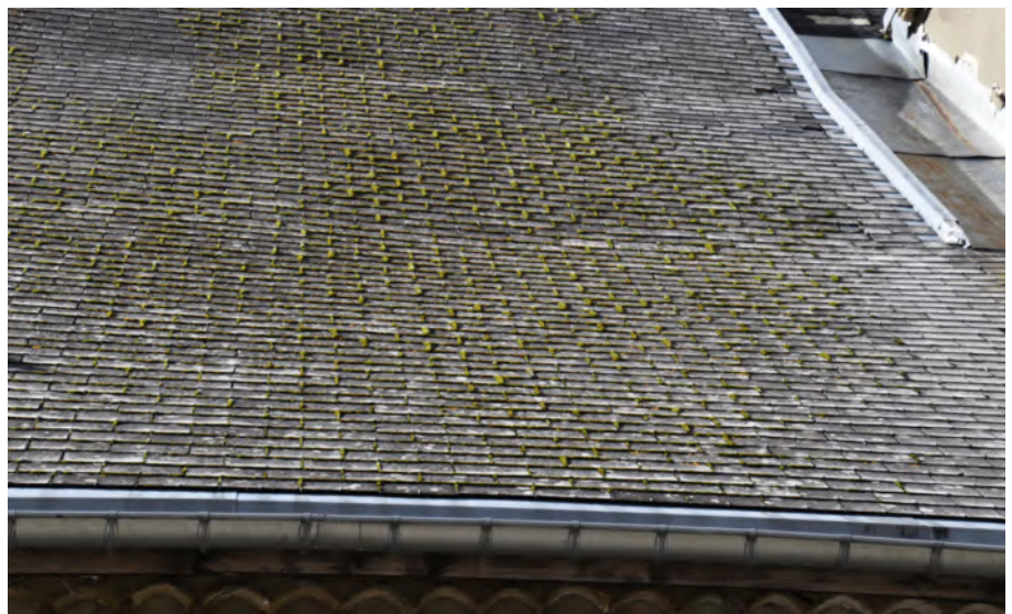
Développement important des mousses en couverture Nord
