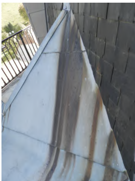
Rouille généralisée des revêtements zinc
