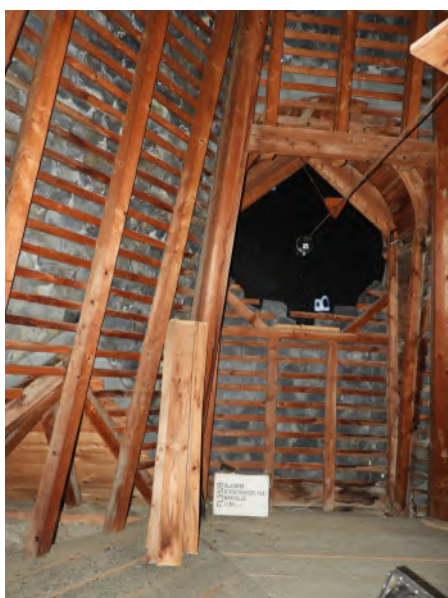
Dégradation de l'ardoise en sous face
