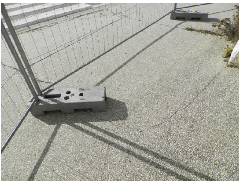
Fissures du béton désactivé : zone au droit du contrefort
