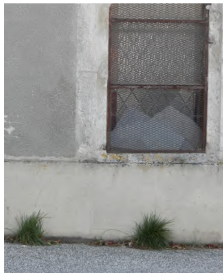
Sous bassement en mortier de ciment - étanche - microfissures - bloque l'humidité dans les maçonneries
