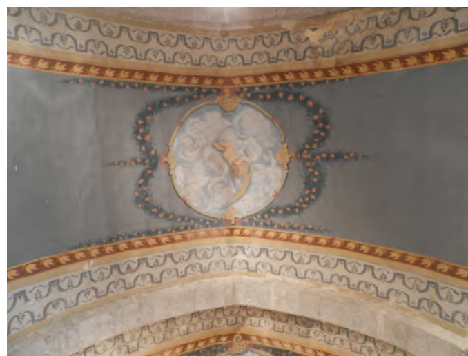
Fissures horizontales sur l'arc Sud de la seconde travée
