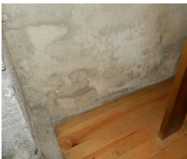
Humidité importante des murs dans la nef - microfissure des enduits
