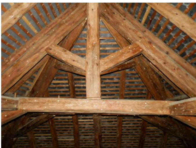
Ouverture importante de l'assemblage entrain-poinçon : renforcement à prévoir
