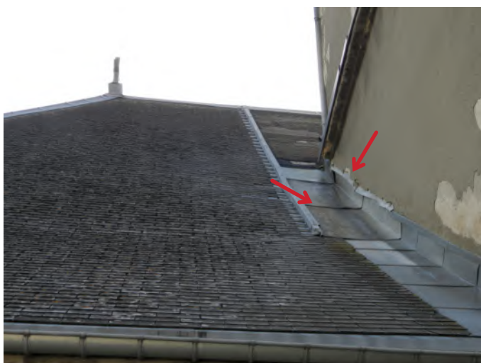
Noe en zinc fortement altérée : joints ouverts, rive en pénétration dégradée, rouille généralisée, mauvaise mise en oeuvre
