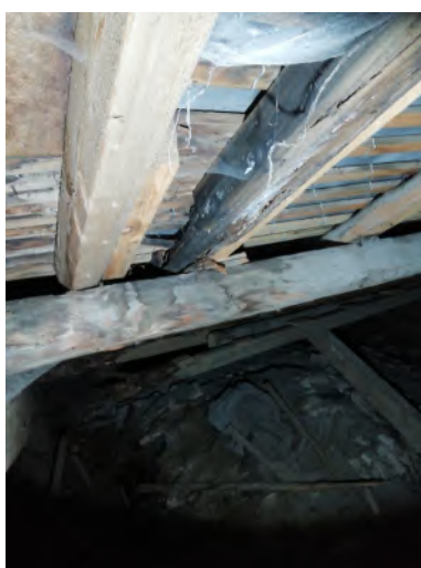
Pannes et chevrons fracturés Chapelle Nord Désordre stabilisé en janvier 2022
