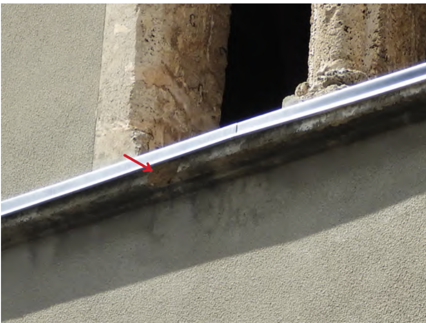
Reprise des bandeaux du clocher en enduit ciment - accélération des altérations de la pierre - fractures et chutes de matière
