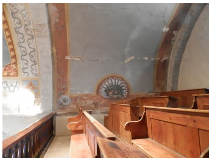
Fissures horizontales et « en escalier » sur l'arc Sud de la première travée
