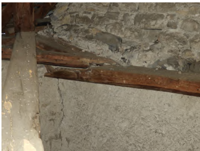
Sablière, support de la demi ferme Sud-Ouest fracturée Consolidation réalisée en janvier 2022 par l'entreprise Beaufils
