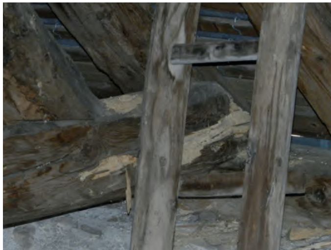
Appui de ferme complètement altéré par une attaque de xylophage
