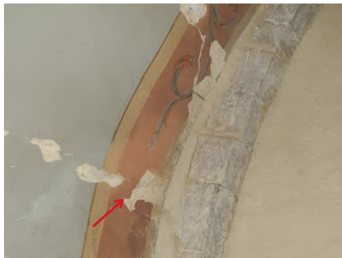
Chute de matière lié au développement des fissures sur voûtes
