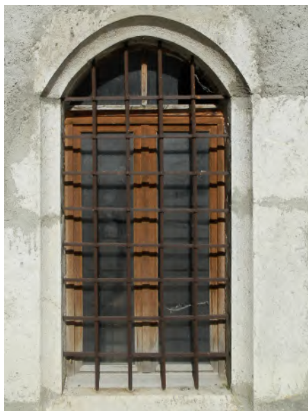
■ Barreaudage en fer forgé corrodé
