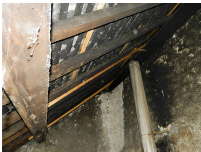
Chapelle Sud - bois de charpente noircit par les anciennes fumées Ancien conduit de cheminée en fibro-ciment
