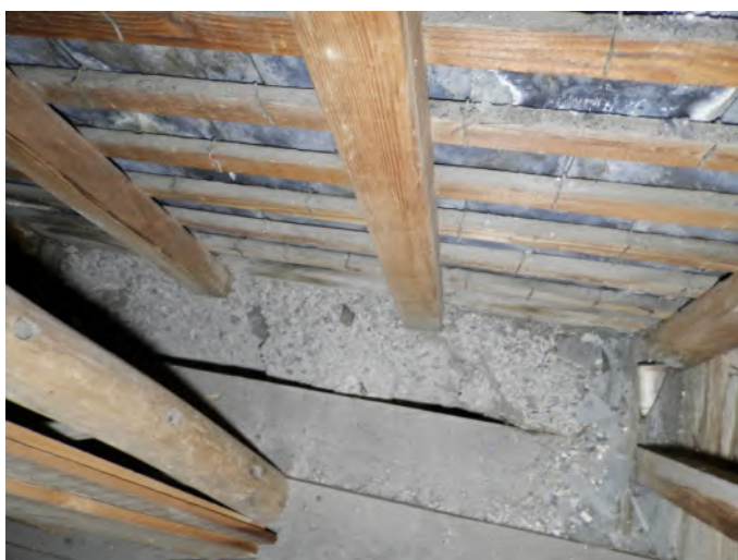
Forte érosion des arases de maçonnerie bétonnées
