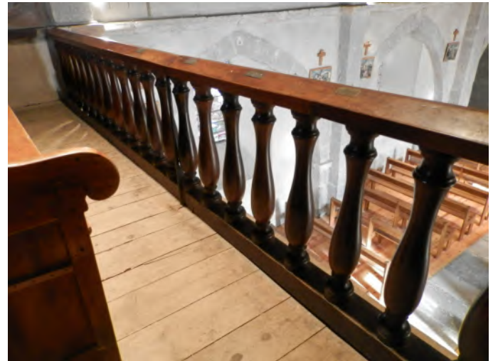
Garde corps hauteur insuffisante
