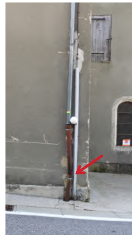
Altération des descentes d'eau pluviale
