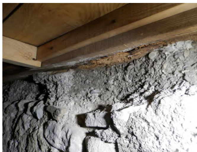
Forte érosion des arases de maçonnerie bétonnées Pourrissement des bois prenant appui dessus
