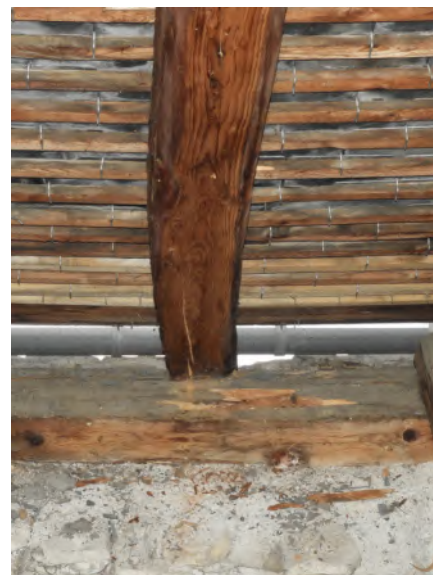
Appui du chevron fragilisé par une attaque de xylophage sur la sablière
