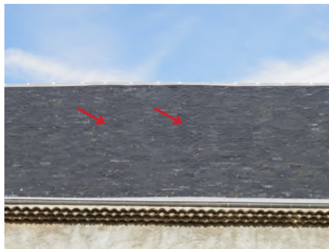
Mouvements de la couverture : sillons verticaux
