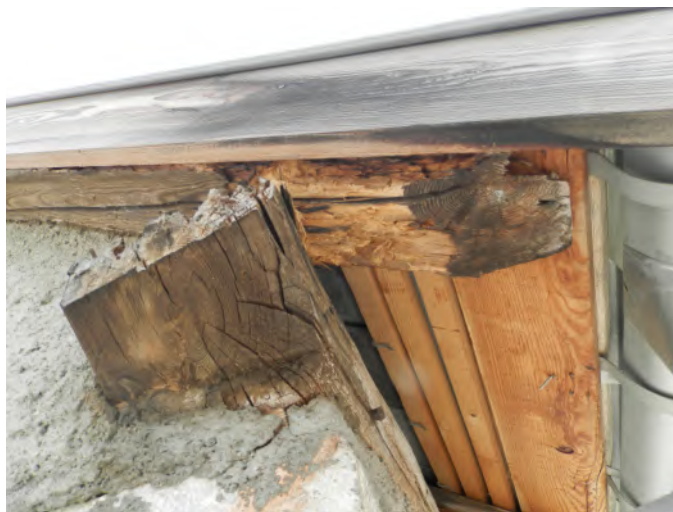
Pourrissement des bois de charpente : porche d'entrée
