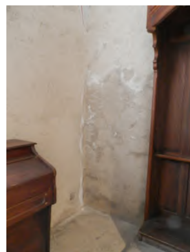
Remontées capillaires chapelle Sud Présence importante de sels
