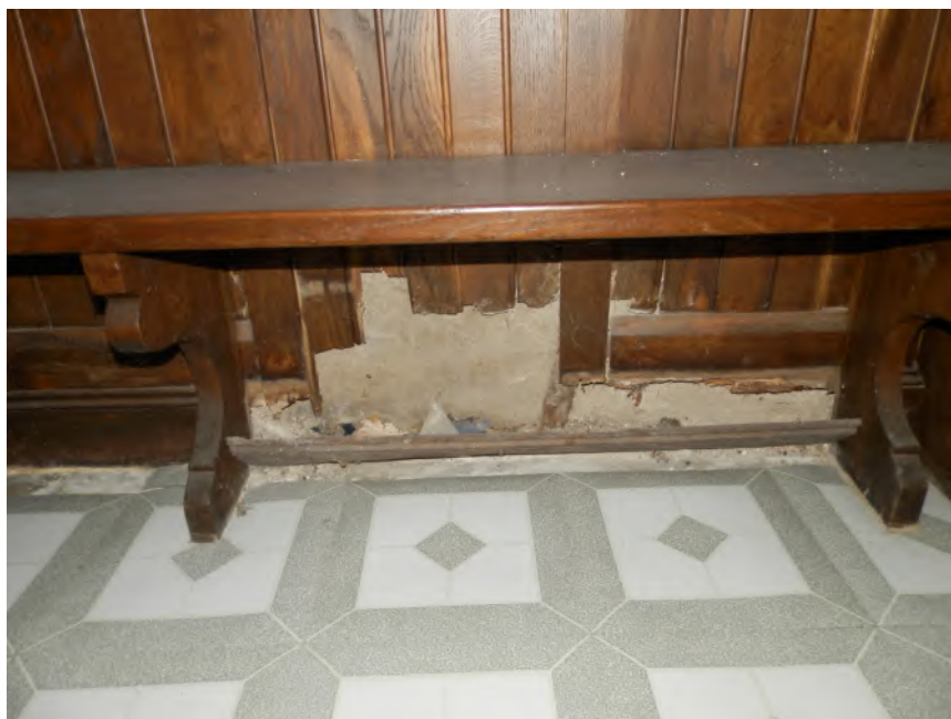
Altération et fracture des bois - Stalles du chœur
