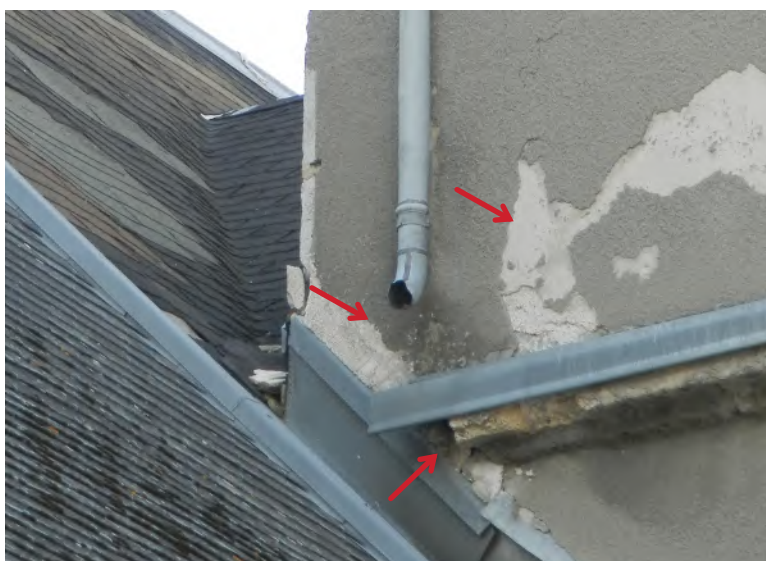
Clocher Est - rejaillissements importants liés à la descente d'eau pluviale - humidité - microvégétaux - déplaquage des enduits - dégradation de la pierre
