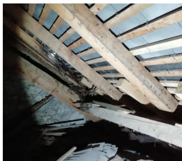
Pannes et chevrons fracturés Chapelle Nord Désordre stabilisé en janvier 2022
