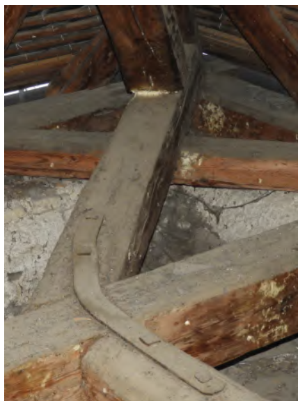
Appui de la demi ferme Sud-Est fragilisée par la présence de champignons ?
