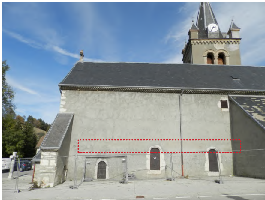
Ventre de la maçonnerie observé sur le mur gouttereau Sud
