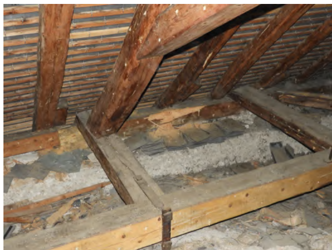
Attaque xylophage en court sur la sablière Nord du chœur. Forte altération au niveau de l'appui de la ferme
