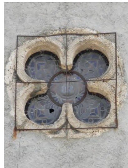
■ Grille de protection datant au moins de 1906 - fortement altérée et corrodée - Coulures et salissures sur les parements dus à la corrosion
