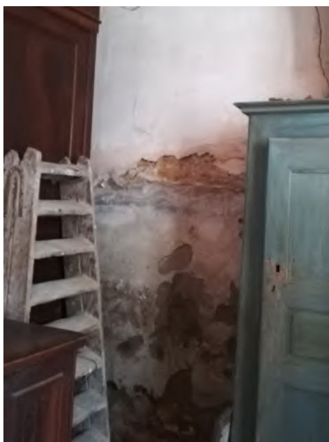
Dégradation avancée des enduits et maçonneries
