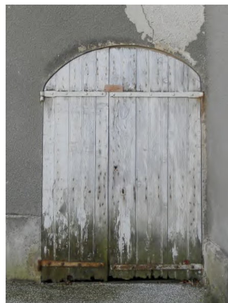
■ Porte en bois d'accès au clocher fortement altérée en partie basse - humidité importante - écaillage de la peinture - pentures en fer forgé corrodées
