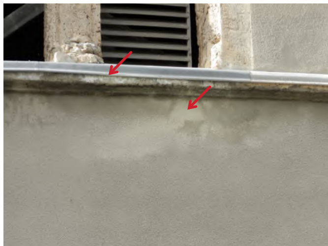
Clocher Est - humidité des maçonneries - Développement de sels
