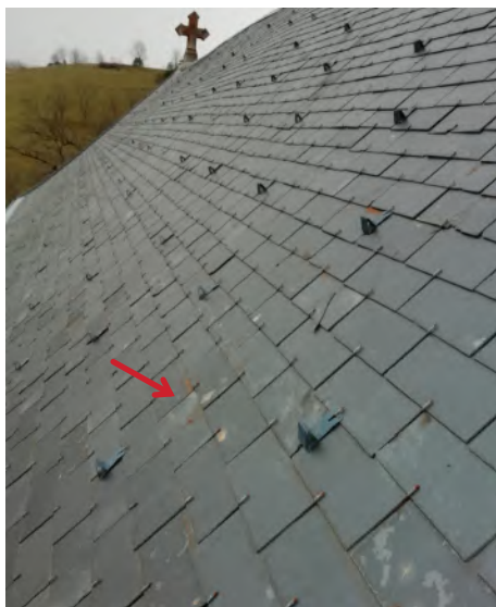
Dégradation de l'ardoise : fractures, érosion, corrosion des crochets de fixation
