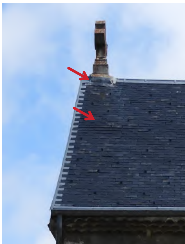
■ Mouvements de la couvertures liée au mouvements de charpente - désorganisation Altération de l'étanchéité de la croix Mise en œuvre des rives latérales disgracieuse
