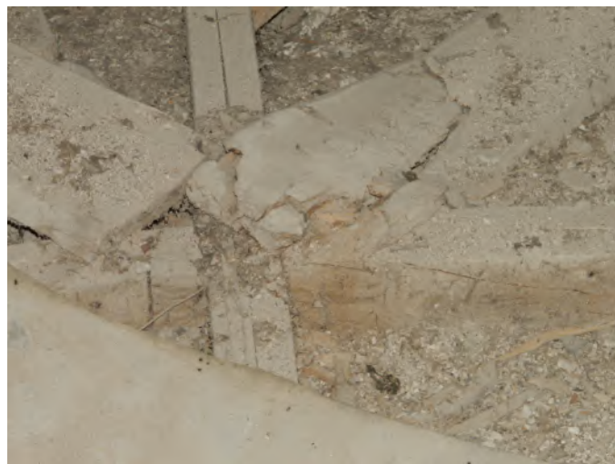
Fragilisation des assemblages
