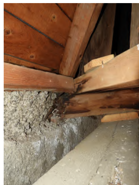
Pourrissement des bois de charpente prenant appui dans les arases bétonnées
