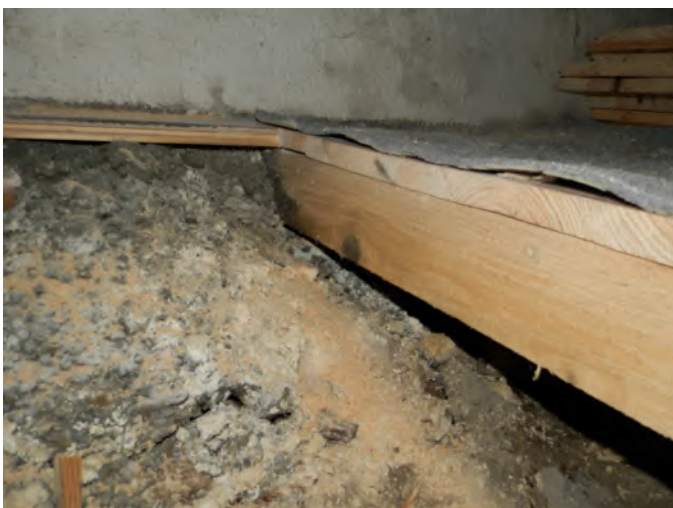
Humidité du sol et des appuis des lambourdes du plancher
