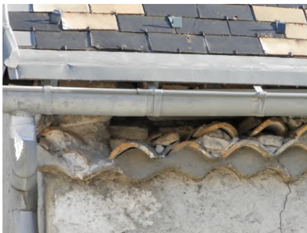
Forte altération des génoises - désorganisation du bas de pente et infiltrations d'eau au niveau des arases des maçonneries
