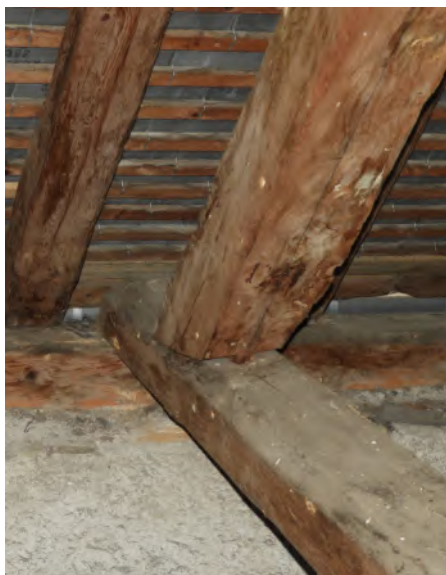
Appui de ferme fragilisé par le pourrissement de la sablière : ouverture importante de l'assemblage à mi-bois
