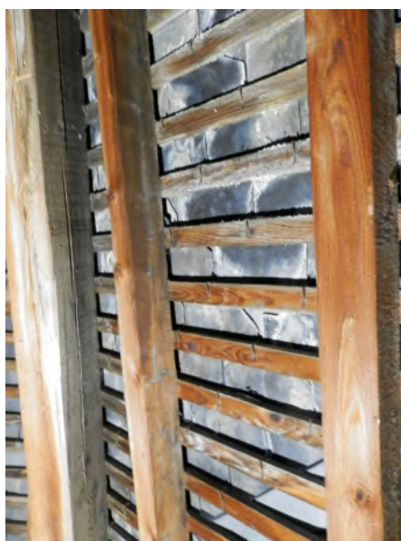
Pyrite généralisée - altération des liteaux
