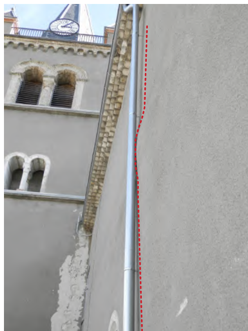
Ventre de la maçonnerie mur gouttereau Nord
