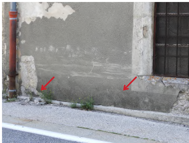
Clocher Nord - rejaillissements et encrassement des maçonneries - Déplaquage des enduits - développement de végétation
