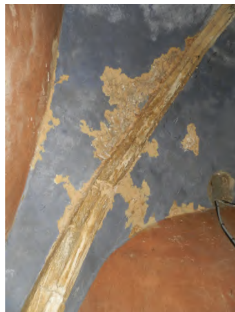
Champignons sur voûtes liés aux nombreuses infiltrations d'eau en toiture - Analyses fongiques réalisées lors des travaux de mise en sécurité - Pas de Mérule dans cette zone
