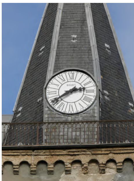
Vétusté généralisée des ardoises de couverture
