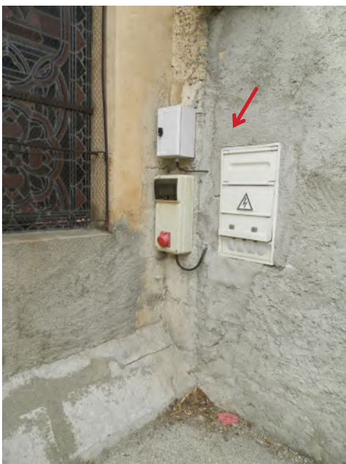
Visibilité des compteurs réseaux disgracieux
