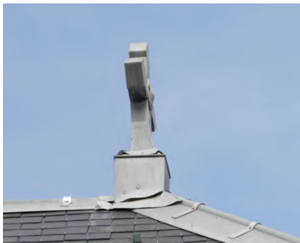
■ Déformation de la croix en zinc
