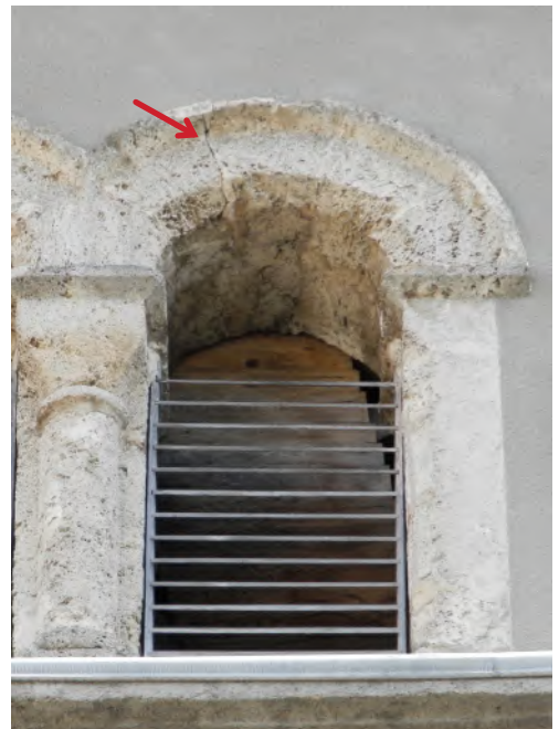
Fissures de la baie géminée
