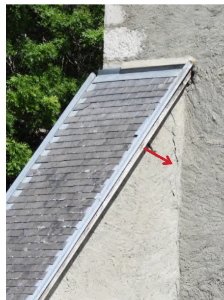
Désolidarisation du contrefort Sud
