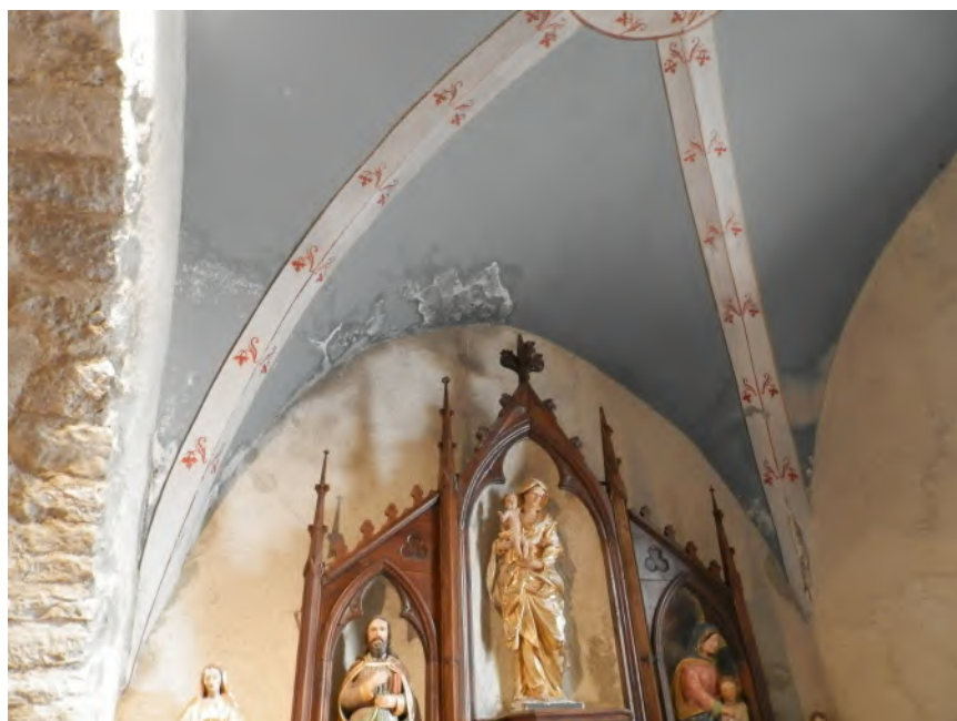
Présence importante de sels et pourrissement Chapelle Sud
