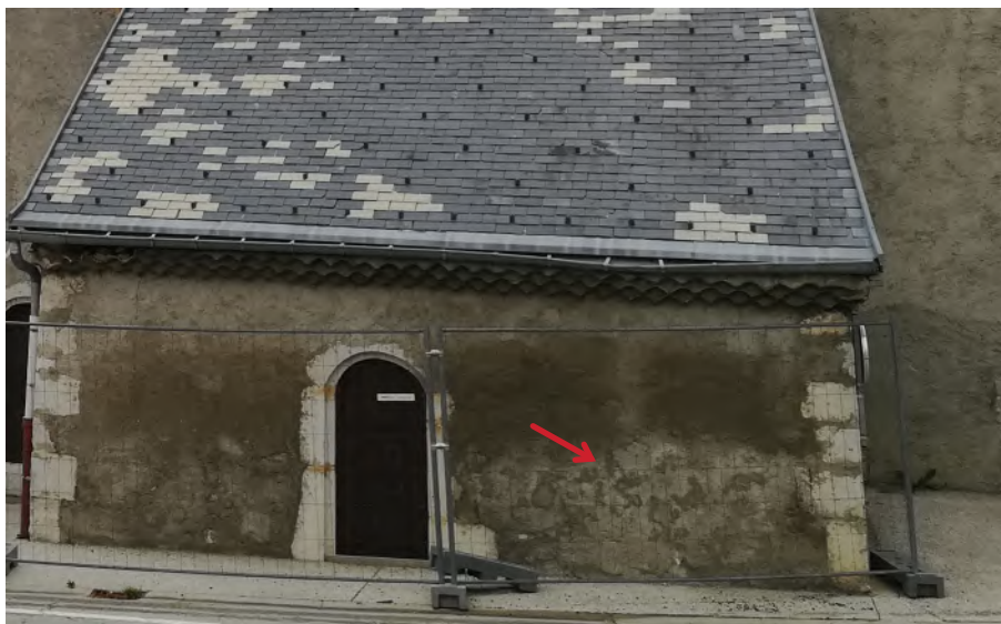
Chapelle Sud - Rejaillissements important - humidité - Remontées capillaires et développement des sels.
