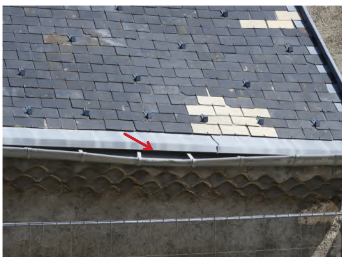
Altération de la gouttière - déversement des eaux de pluie - rejaillissements Mise en œuvre maladroite des bas de pentes en zinc
