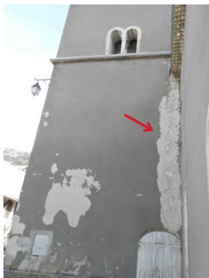
Clocher Ouest - ruissellement important depuis la génoise ayant entraîné la chute des enduits
