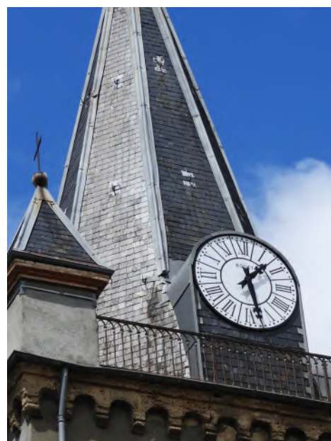
Vétusté généralisée des ardoises de couverture
