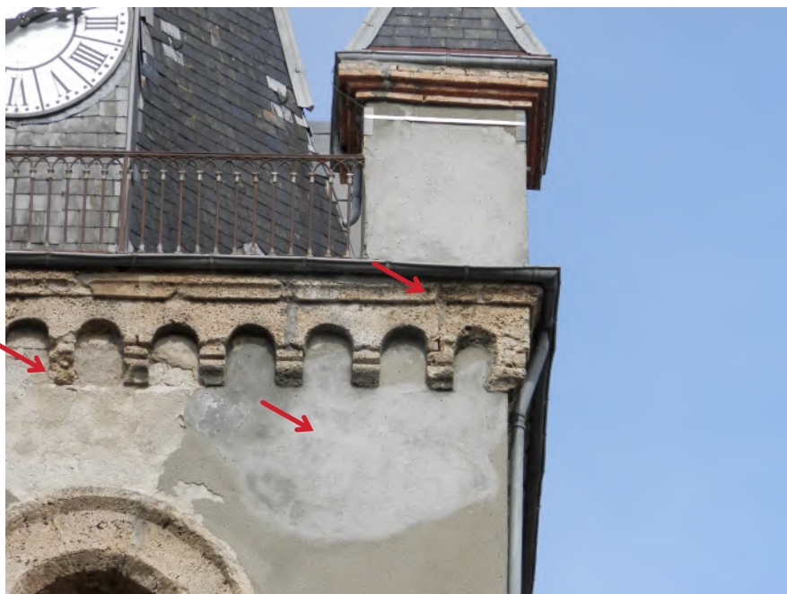
Clocher Sud - Reprises importantes au ciment - accélération de la dégradation des pierres de tuf - Décollage des enduits
