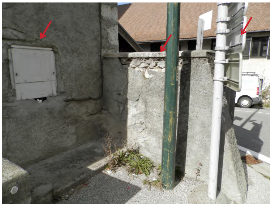
Maçonnerie inutile et disgracieuse - à démolir
