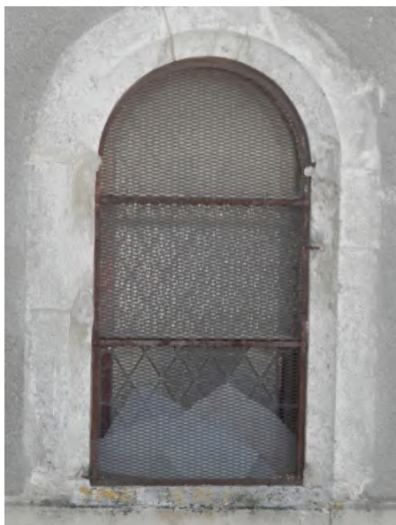
■ Verrière de protection brisée - grille de protection avec armature en fer forgé corrodée
