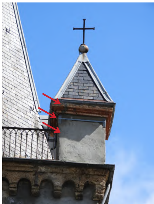
Consolidation du clocheton avec un enduit ciment - fissures - déplacements - altération importante de la brique
