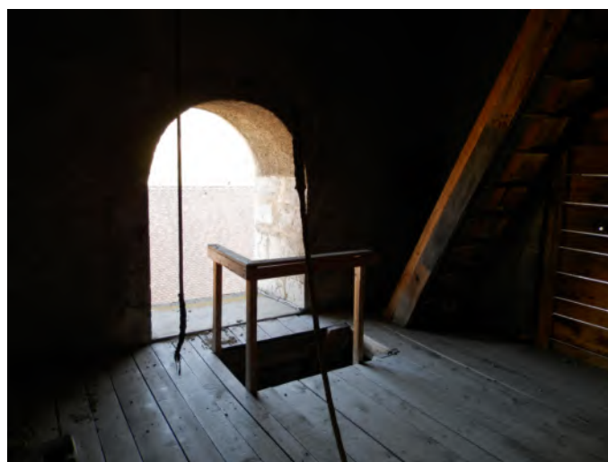
Absence d'obturation des baies - Entrées d'eau Une occultation en bois provisoire a été réalisée par l'entreprise Beaufils en janvier 2022
