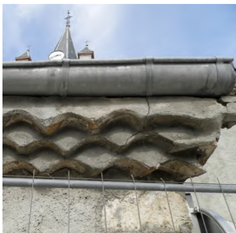
Génoises au mortier de ciment - fractures conduisant à des entrées d'eau
