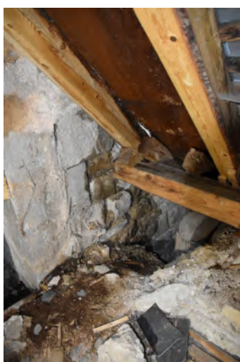
Lessivage des maçonneries des bois de charpente à la jonction du clocher et de la toiture de la chapelle Nord
